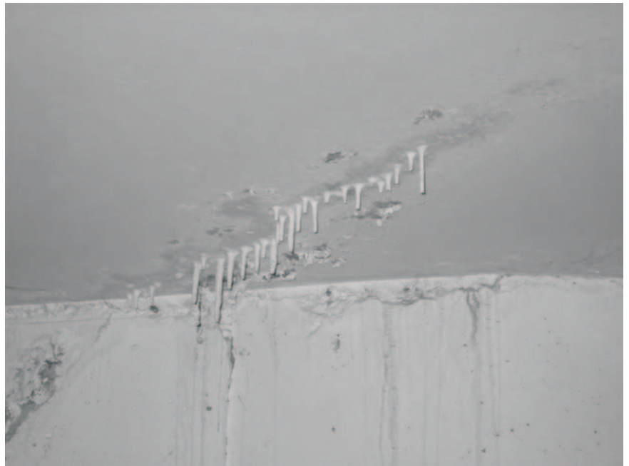
Typische Tropfsteinbildung an einem Riss in einer Betondecke
